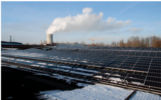
LES TOITS DE PRODECOR orientés vers le sud sont désormais couverts de panneaux photovoltaïques. Ils produiront au moins un quart de la consommation électrique de la société. © D.R.
